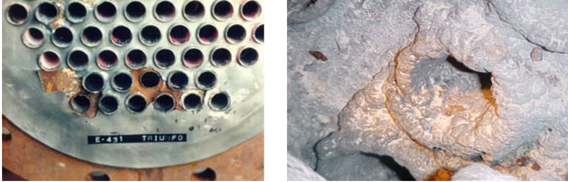
Fig. 27 e Fig. 28 – Incrustações em permutadores e caldeiras [40].
