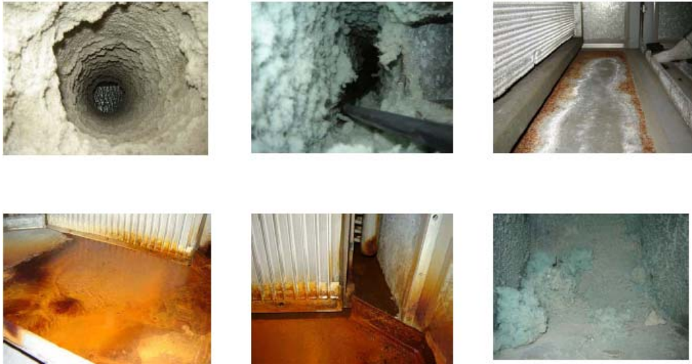
Fig. 21 – Imagens do interior de UTA's, condutas e bateria/permutador [36]
