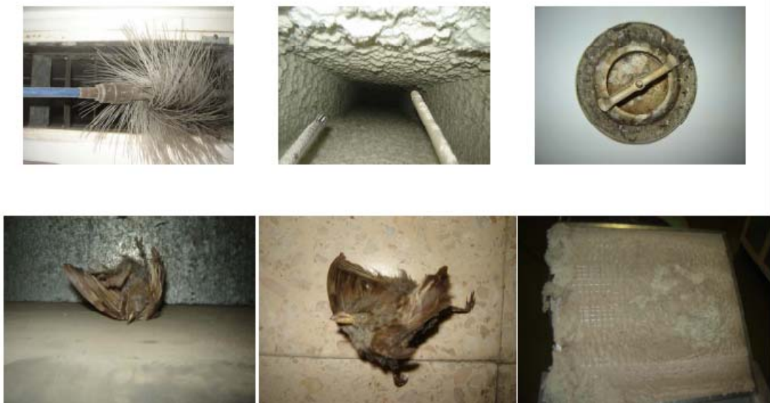
Fig. 22 – Pássaros encontrados dentro de uma conduta de climatização e filtros totalmente colmatados [36]
