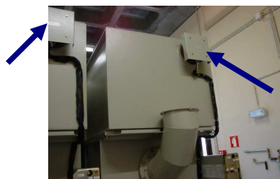
Figura 6.22 - Tampas metálicas de acesso aos transformadores de medida de tensão.
