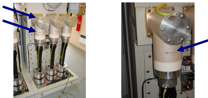
Figura 6.21 - Cabeças de ligação dos cabos de entrada e saída de 60kV.
