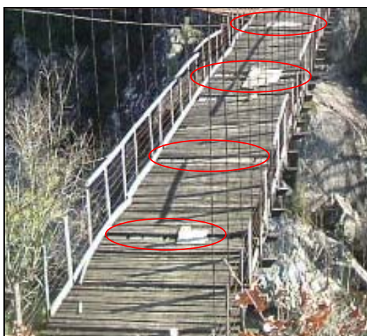
Figura 3.25 – Falta de elementos no pavimento (Vista desde E1).
