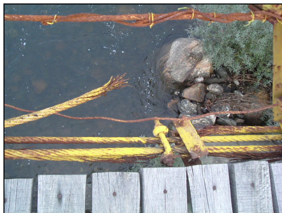
Figura 2.60 – Rotura de cabos entretanto substituídos.
