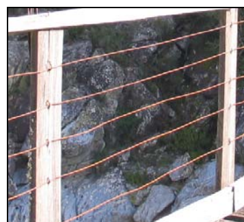
Figura 3.32 – Corrosão nos arames das guardas.
