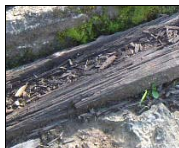
Figura 3.29 – Degradação do barrote junto ao encontro E2.
