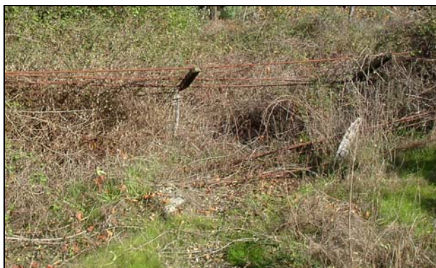
Figura 2.50 – Vista dos quatro cabos de arame e de dois barrote (degradado).
