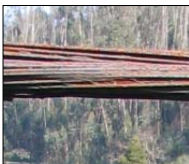
Figura 3.30 – Pormenor de um cabo principal.
