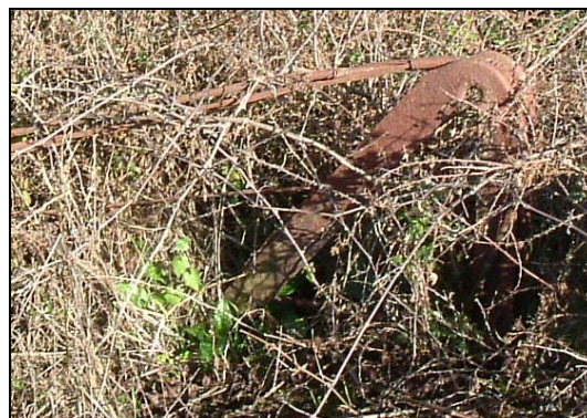
Figura 2.51 – Suporte de cabos junto à ancoragem.
