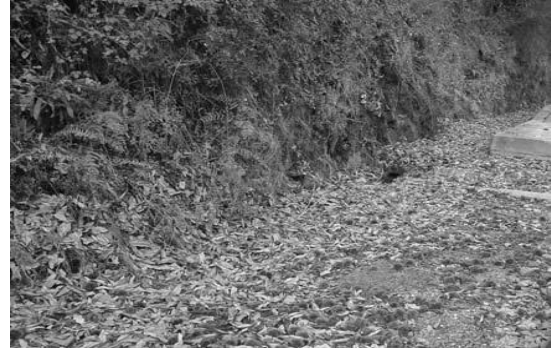
Fig.136 – Valeta obstruída (GEG)
