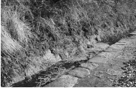
Fig.135 – Valeta de pé de talude alagada (GEG)
