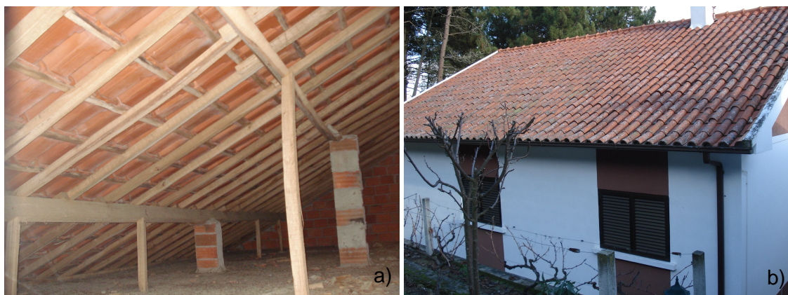
Fig. 4.5 a) e 4.5 b): a) vista interior da cobertura a partir do desvão não útil; b) Vista exterior da cobertura
