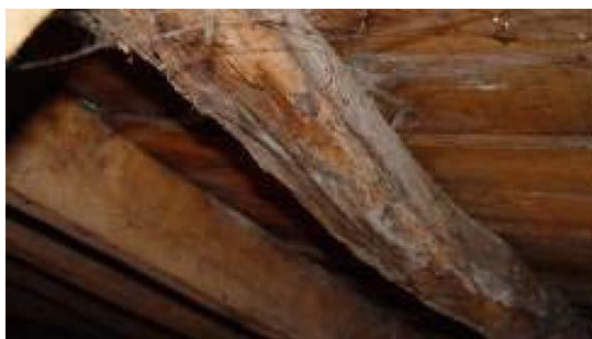
Fig. 32 – Viga de pavimento excessivamente deformada [31]
