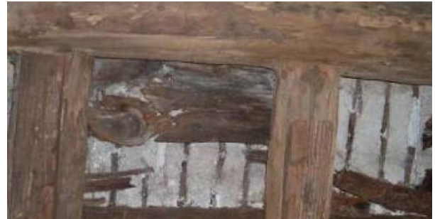
Fig. 31 – Degradação causada devido à construção de lajeta de betão. (Dias [18])
