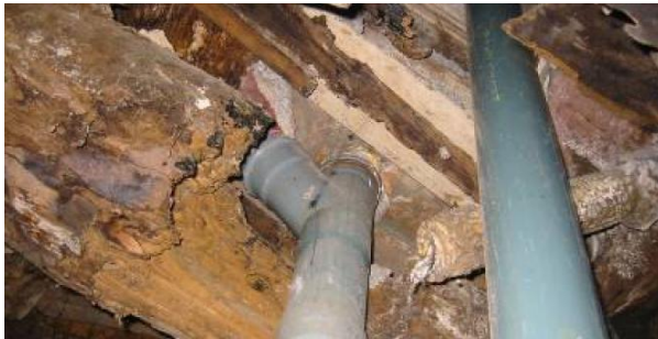
Fig. 30 – Degradação causada pela instalação de tubos de drenagem. (Dias [18])
