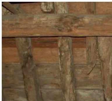
Fig. 6 – Vigas de secção circular (Edifício da R. do Infante D. Henrique nº87-91 - Porto)
