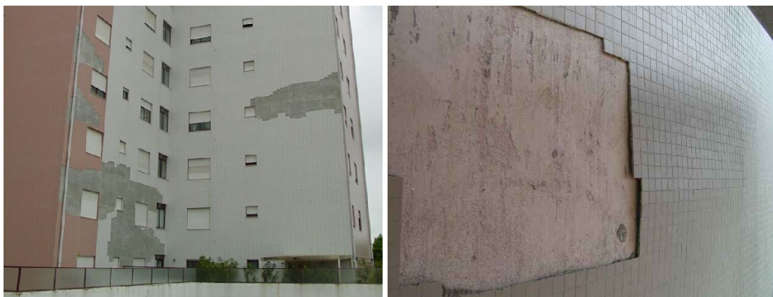
Figura 2.1: Destacamento de ladrilhos cerâmicos em paredes de fachadas
