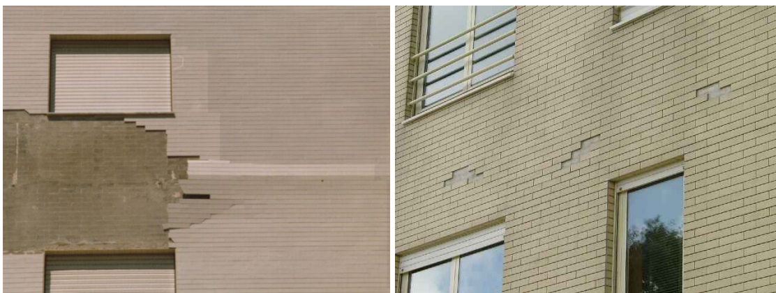
Figura 1.1: Descolamento e destacamento de ladrilhos cerâmicos em paredes de fachadas
