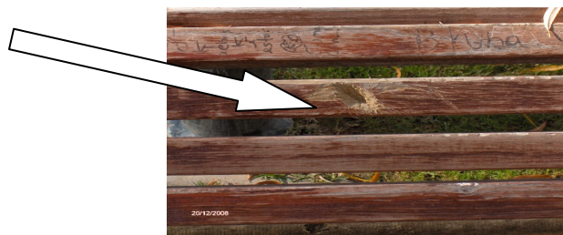
Fig. 4.2 – Exemplo de um banco de jardim com necessidades de emassamento, devido a actos de vandalismo
