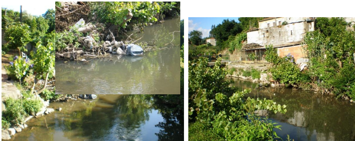
Figura 4.11 – Vista geral das margens do Rio Tinto a jusante da Ponte de Pêgo Negro e pormenor da margem esquerda caída no leito (à esquerda)
