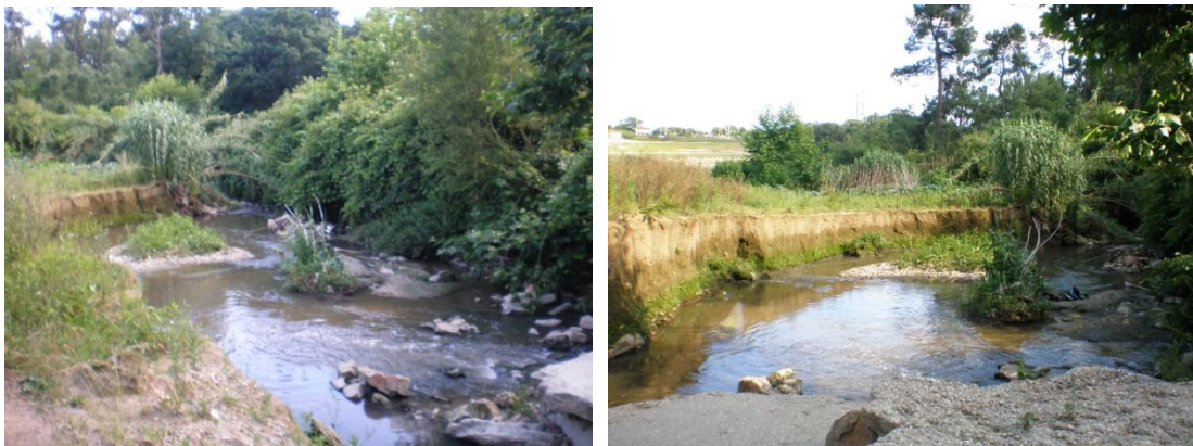
Figura 4.17 - Vista de jusante da passagem junto à IC29 e pormenor da forte erosão da margem esquerda do rio (à direita)
