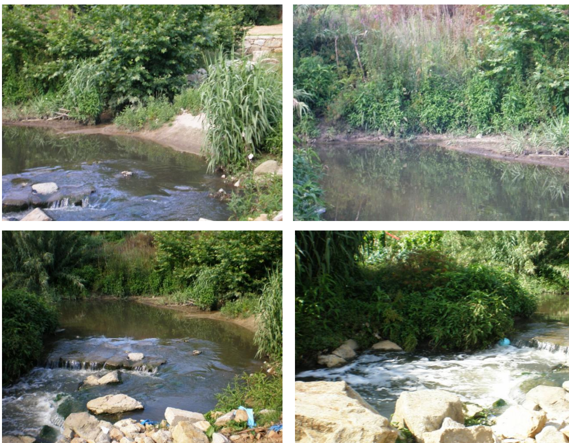
Figura 4.20- Forte erosão sobre a margem esquerda a jusante do pequeno açude (em cima); enrocamento parcialmente caído no leito (em baixo)
