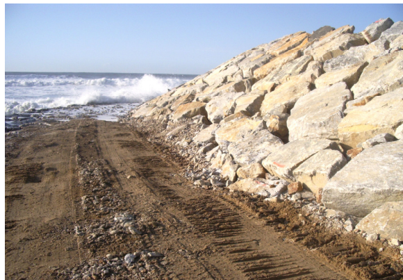
Fig.D.9 – Estrutura longitudinal aderente da frente edificada, antes do reperfilamento da banquetta intermédia, em Cortegaça (13.01.2009).
