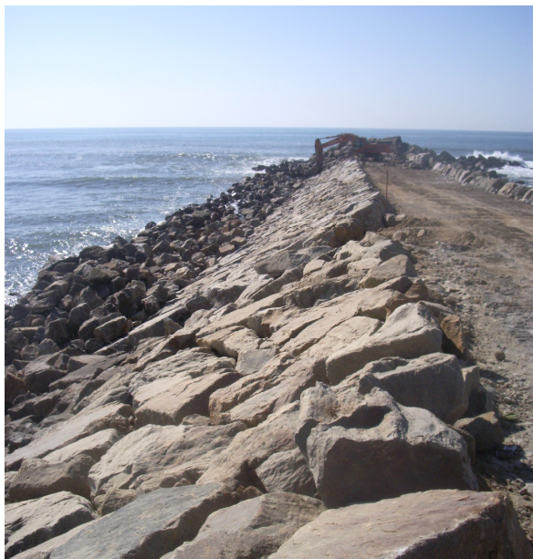
Fig.D.14 – Talude sul do esporão de Cortegaça todo reperfilado (18.03.2009).
