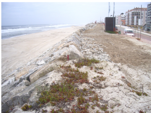
Fig.D.21 – Estrutura longitudinal aderente da frente edificada com talude exposto reperfilado, faltando a zona de coroamento, na Vagueira (9.05.2009).
