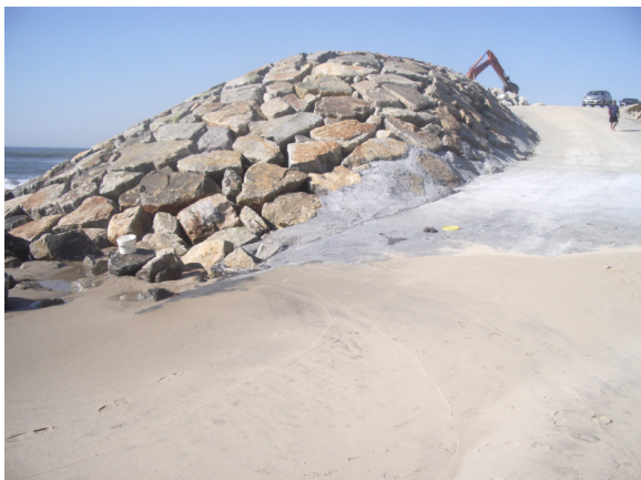
Fig.D.1. – Rampa de acesso das embarcações com conclusão de betonagem e talude exterior pronto, em Esmoriz (18.03.2009).
