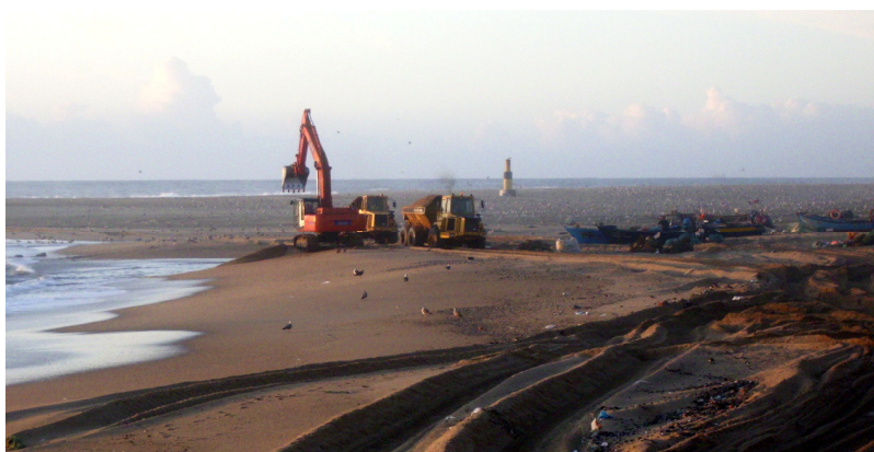
Fig.A.5 – Giratória e camiões trabalhando na remoção de sedimentos da praia da Aguda para alimentação artificial da praia da Granja (13.01.2009).
