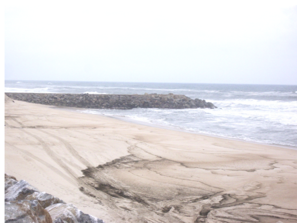
Fig.D.20 – Esporão da praia da Vagueira sofrendo trabalhos de reconstrução da cabeça (9.05.2009).
