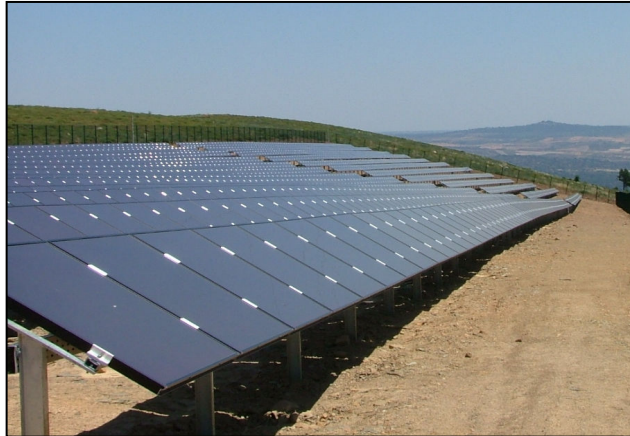
Figura 2.20 – Sistema ligado à rede eléctrica (Central de Lamelas) [F18].
