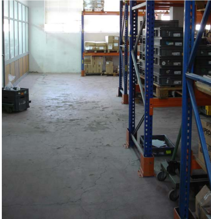
Figura 22 – Chão do antigo armazém danificado e sujo
