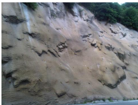
Figura 38 - Projecção de cimento, correspondente a uma intervenção realizada a um talude junto ao rio Douro.
