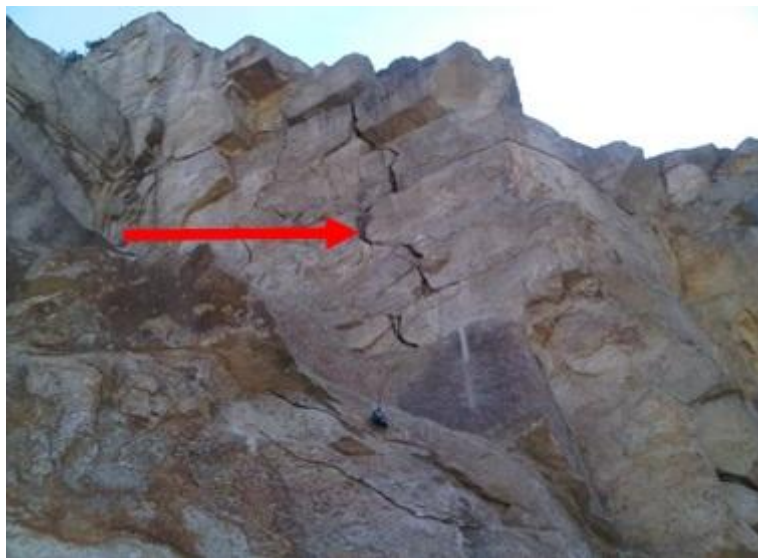
Figura 21 - Destaque para a instabilidade do talude à cota 370-390.
