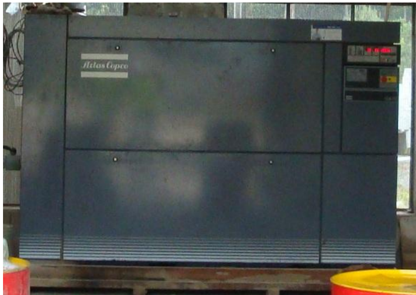
Figura 10 - Compressor de ar a operar na empresa.
