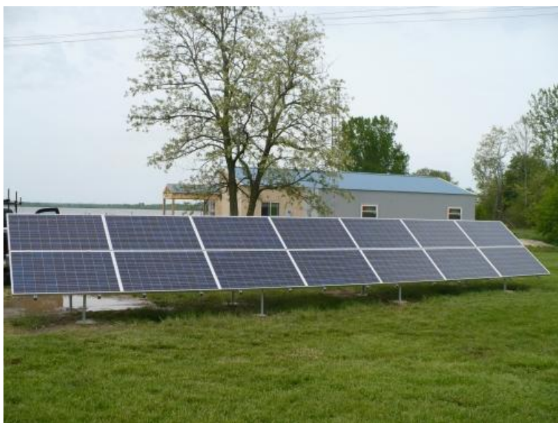
Figura 2.20. Sistema fotovoltaico autónomo [39]
