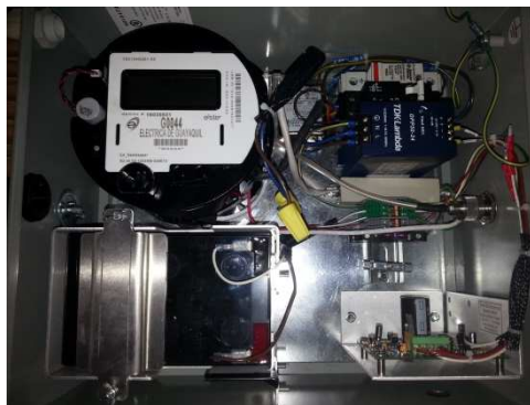
Figura 3. 8: Medidores Gateways o concentradores Fotografía tomada por el autor
