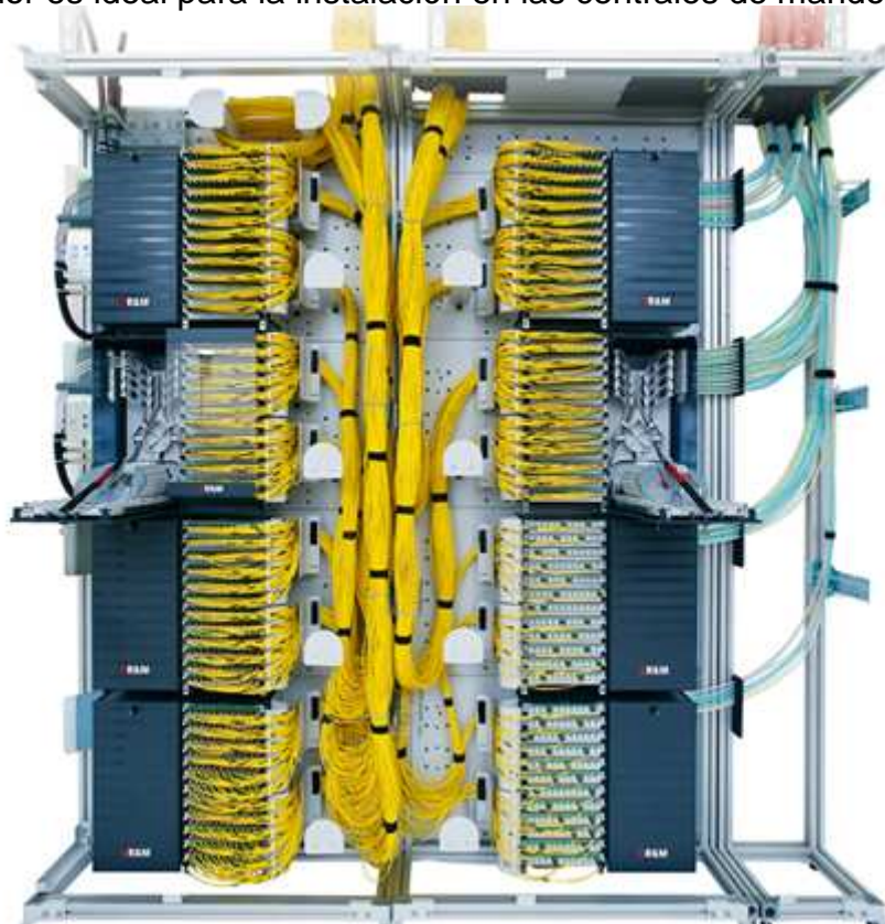
Figura 3.a Bastidor de conexión de fibra monomodo
