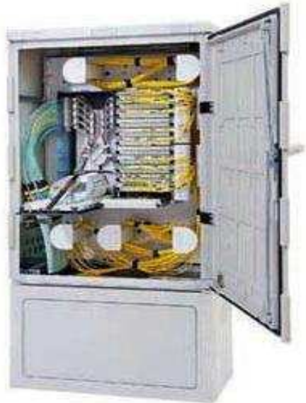
Figura 2.a Armario de conexión de fibra monomodo (Street Cabinet SCM)
