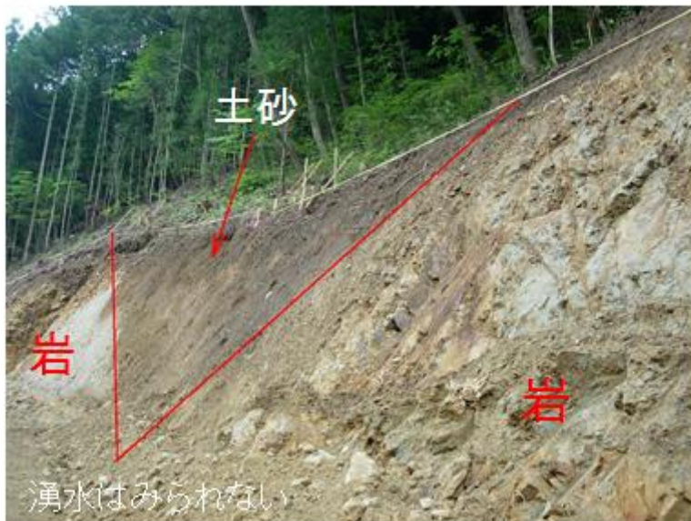
写真 5-1 ブロック積み擁壁の背面
