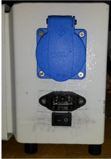
Slika 3.2: Vtičnici in stikalo za vklop nadzorne enote
