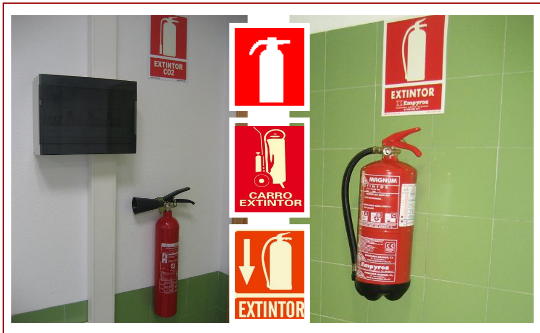
FIGURA 16. Extintores. Señales relativas a los equipos de lucha contra incendios.
