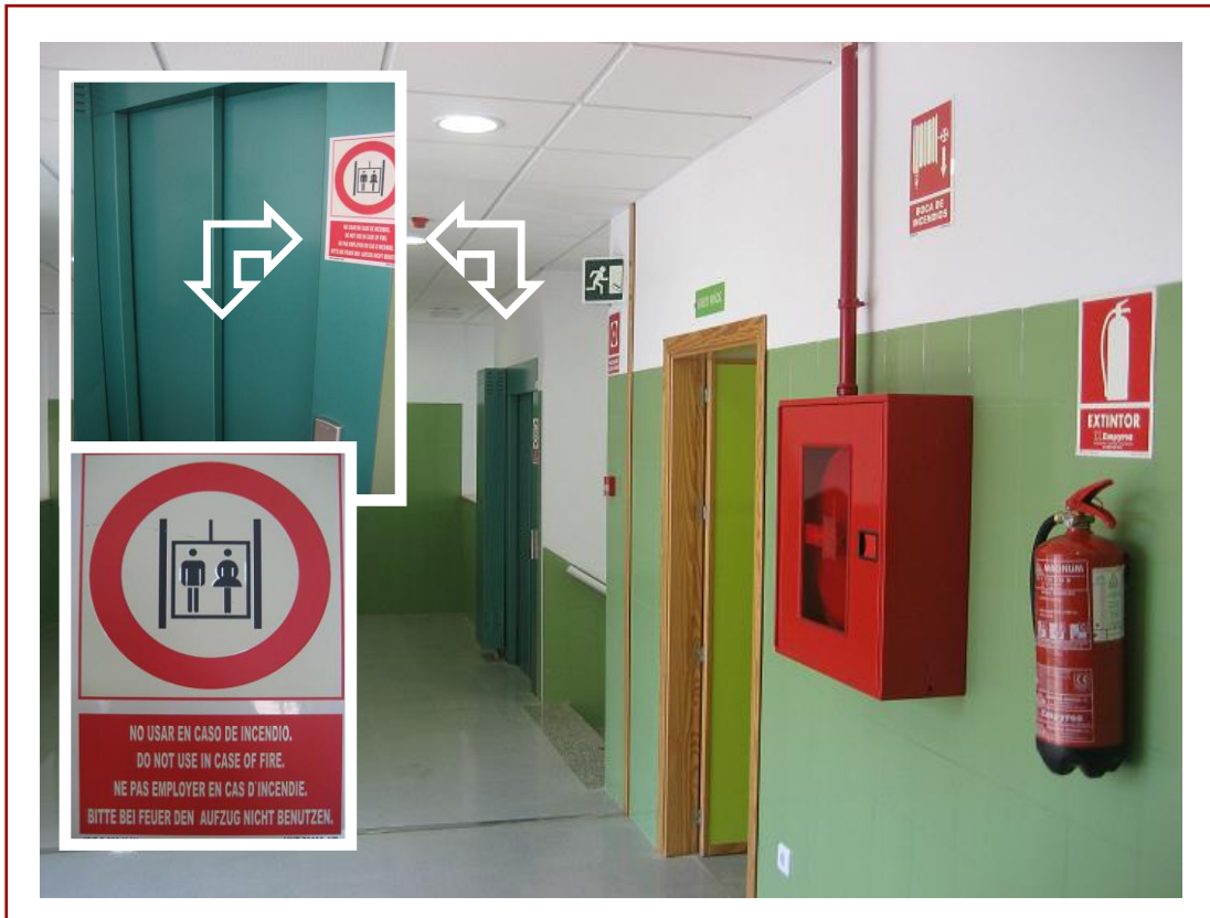
FIGURA 24. Ascensor y señalización de prohibición de uso en caso de incendio, en primera planta de un centro público de reciente construcción (2006).
