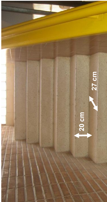
FIGURA 9. Huella y contrahuella de escalón, en escalera de un centro público de “Gran Casco”, de construcción anterior a 1997.
