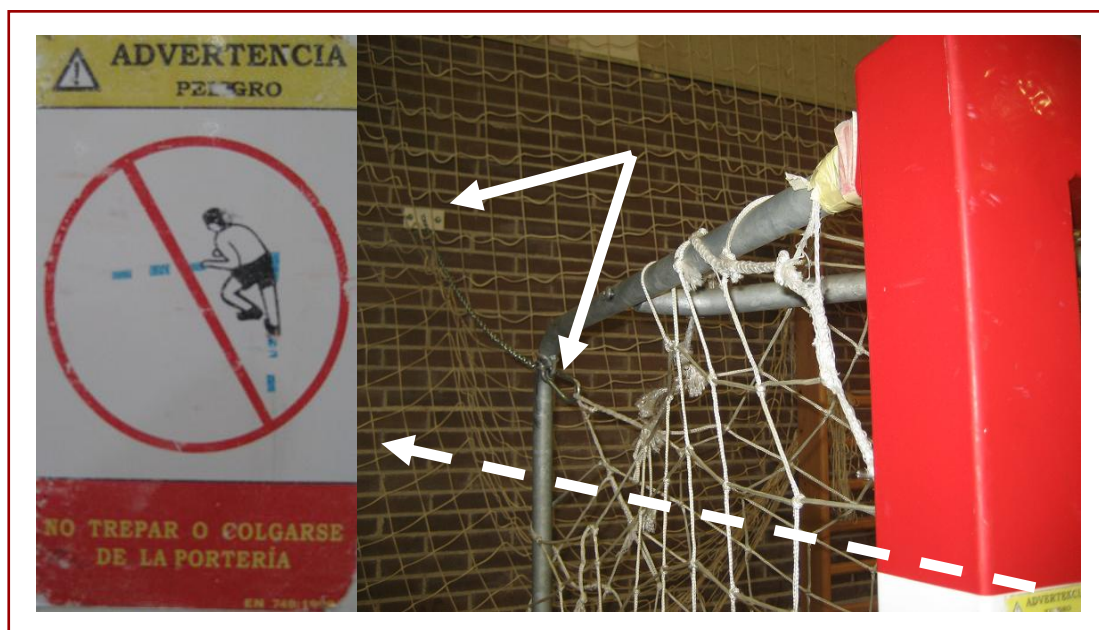
FIGURA 25. Sistema de fijación a la pared y señalización de peligro de caída, de una portería de balonmano en un pabellón polideportivo municipal de uso escolar.
