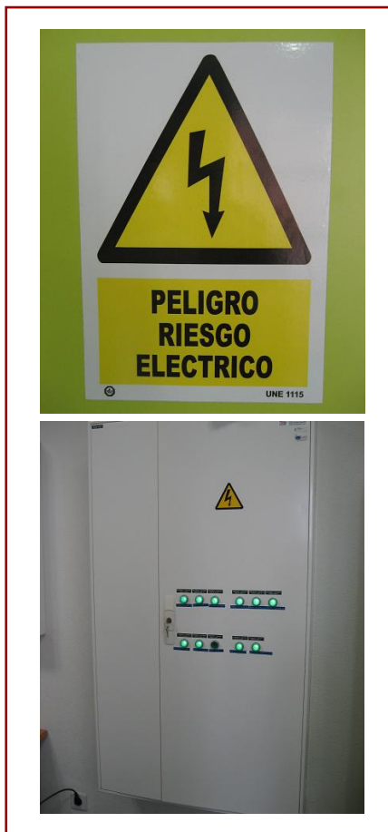
FIGURA 22. Cuadro eléctrico en conserjería de un centro público y señalización en la puerta de entrada a dicha dependencia.
