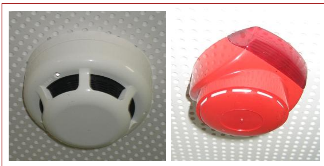
FIGURA 17. Detector de humo (blanco) y sistema de alarma contra incendios (rojo), en centro público.
