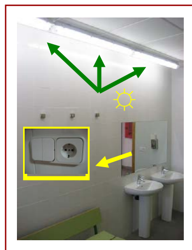
FIGURA 23. Luminarias adecuadamente instaladas y aisladas, en el aseo de un centro público que, sin embargo, presenta interruptor y toma de corriente cercanos al área de lavabos.
