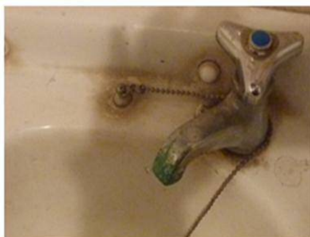
写真-2.8 水道蛇口の緑青
