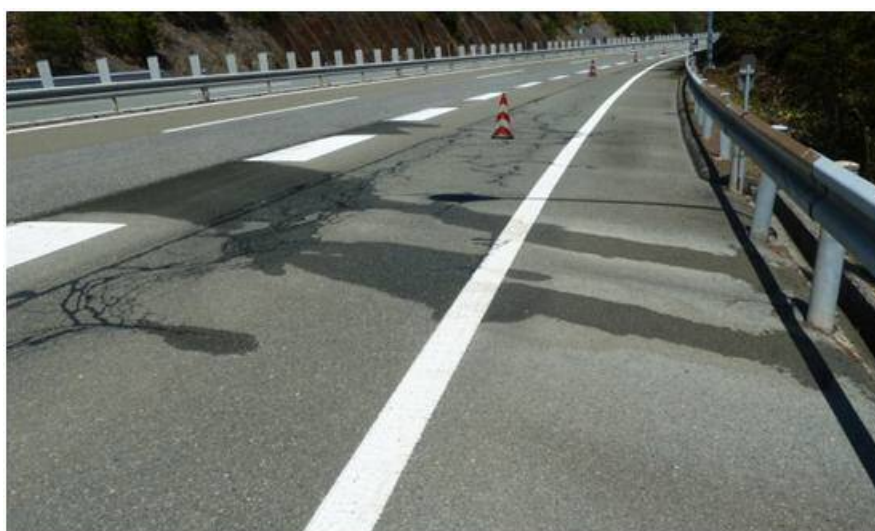
写真-3.5 散水試験による道路下流部での溢出状況
