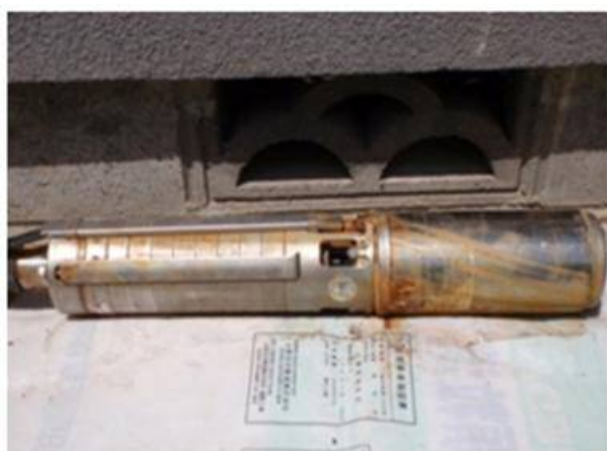
写真-2.6 モーターポンプの腐食
