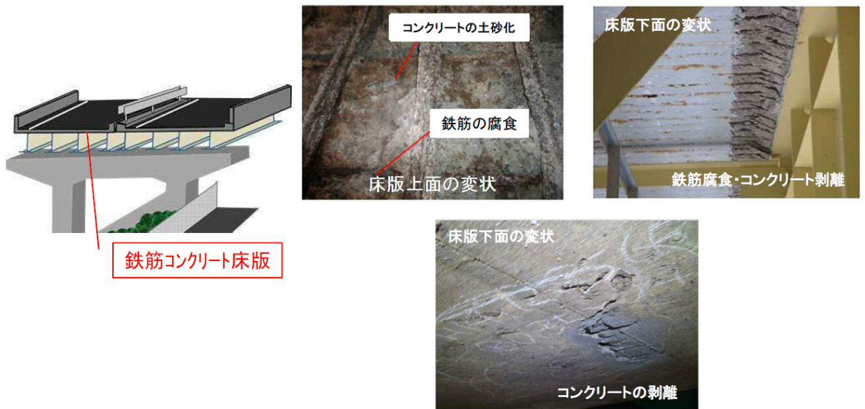
図-1.6 鉄筋コンクリート床版の主な変状 ³)
