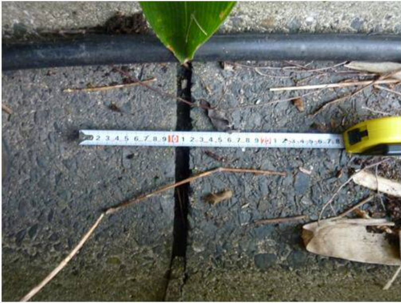
写真-7.1 水路の目地損傷箇所
