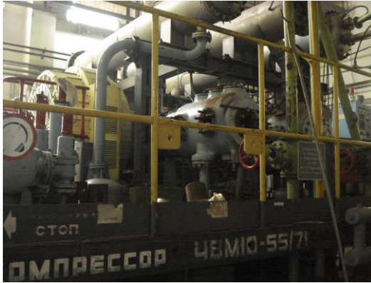
Рисунок 3.19 – Загальний вигляд повітряного компресора 4BM10-55/71
