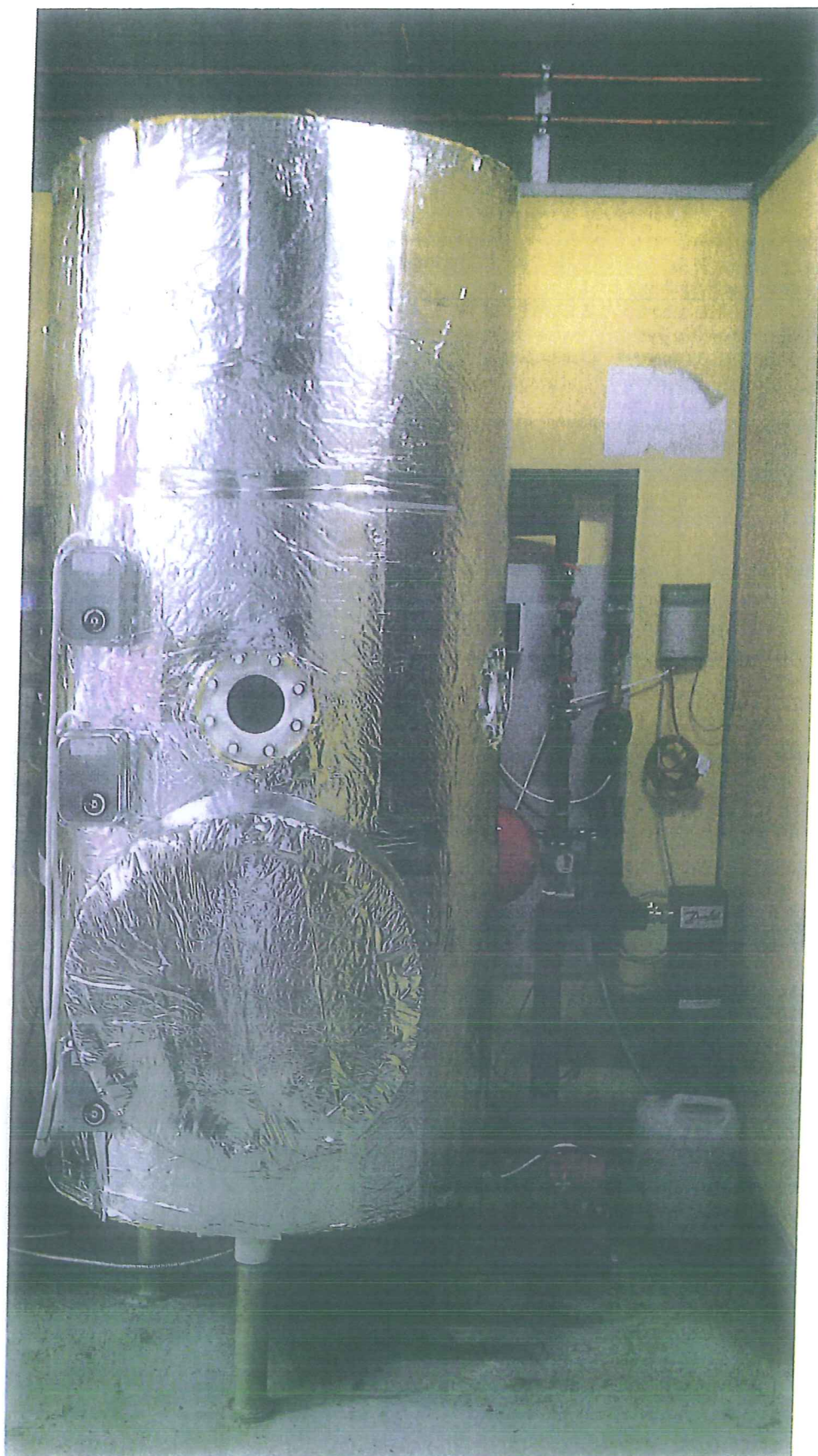
Tre solvarmeanlæg med forskelligt udformede intelligente varmelagre er for tiden under afprøvning i DTU Byggs provestand for solvarmeanlæg. Hvert anlæg, som har et solfangerareal på 9 m 2 , er baseret på et 725 l varmelager fra Ajva.
