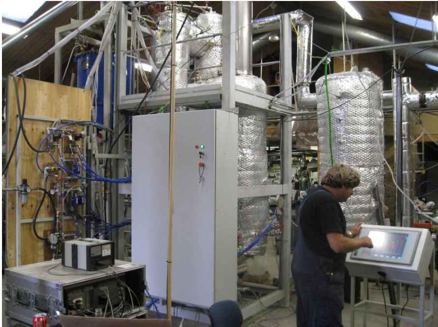
Figur 4: 100 kW LT-CFB forgasser på DTU, med påbygget PLC-skab og fritstående kontrolpanel til højre, -set fra sydøst.
