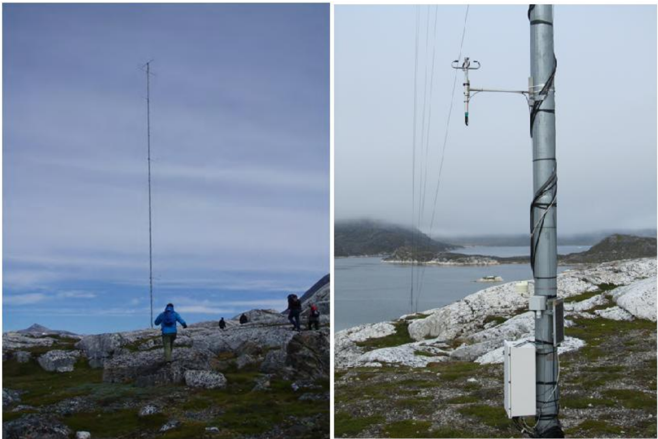
Figur 30 Installerede følere i Nanortalik
