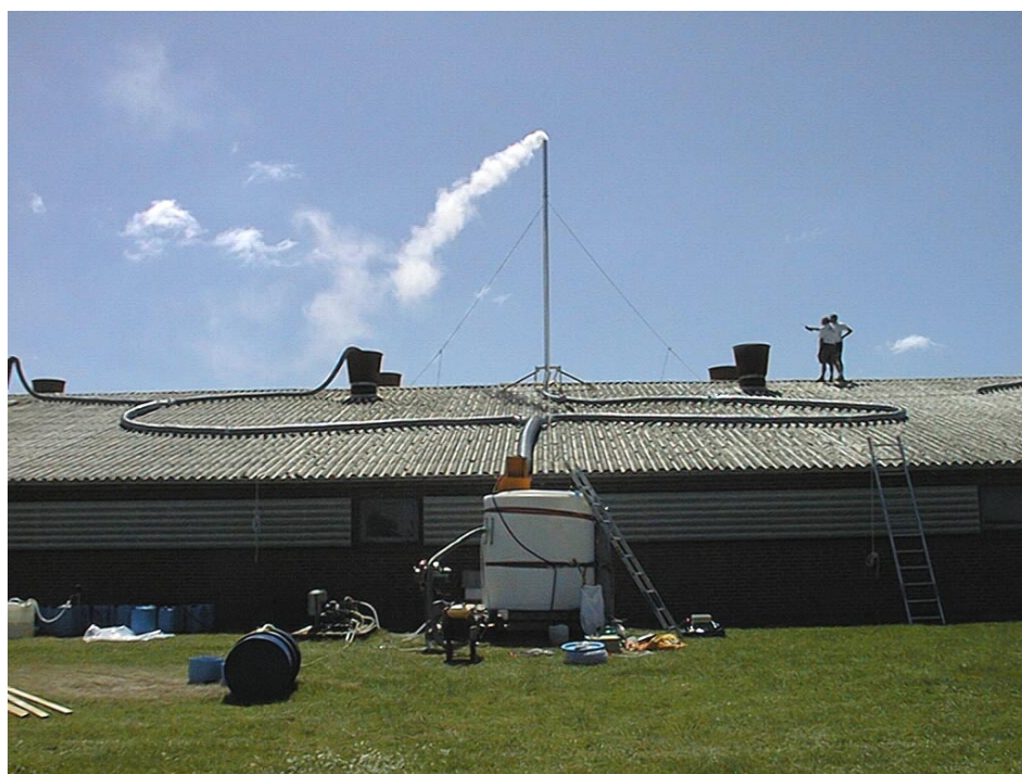
Figur 2-1 viser Røgmaskinen tilsluttet et forhøjet afkast (+ 6 meter over kip). Den store hvide beholder er blandingstanken hvor syre og basevæskerne sprayes sammen via en luftdysse, og danner aerosol "røg", som så pumpes ud til dyserne gennem slangerne på taget. Røgslangerne på taget er fleksible, og kan derfor trækkes hen til de respektive udluftninger som skal have tilsat røg.
