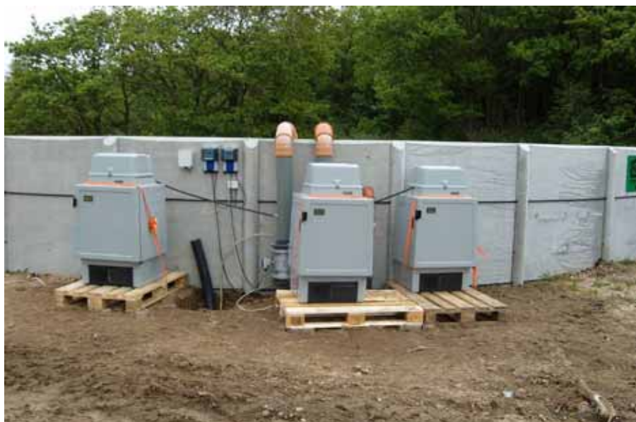
Figur 4.2 Tre ISCO 6712-1 vandprøvetagere opstillet ved slamtank på Abildtrup Dambrug til prøvetagning af slamvand fra tømning af slamkegler og returskylning af biofiltre. Endvidere ses display (blå bokse på væg af slamtank) til aflæsning af vandmængder målt med vandure.
