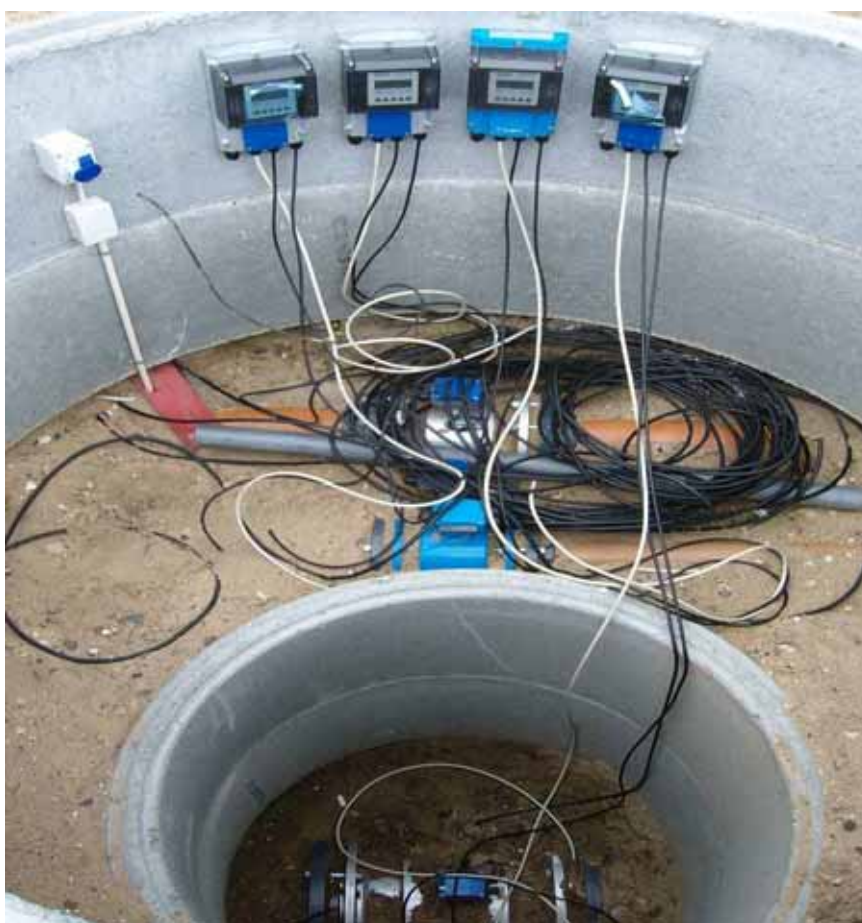
Figur 4.3 I bunden af brønden vandure. På siden af rør 4 display-enheder som anvendes til at aflæse øjeblikks vandføring i forskellige tilløb/afløb på dambrug.
