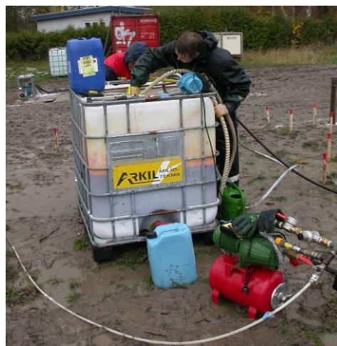
Figur 10: Injectionsanlægget til injection i fraktureringsboringer.
