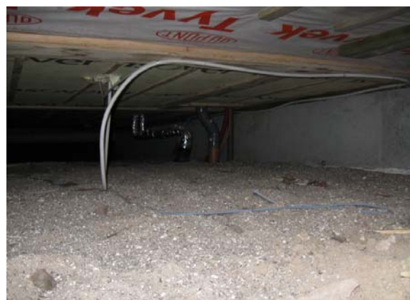
Figur 79 delvis fugtspærre under gruset, isolering er defekt
