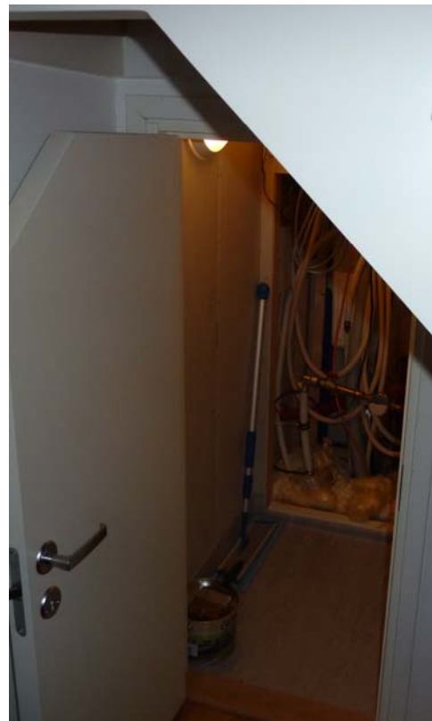
Figur 66 Teknikrum er placeret under trappe
