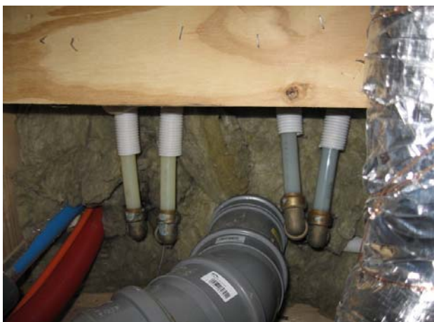
Figur 80 Eksponerede rør under gulv, manglende vindspærre
