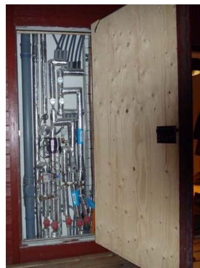
Fig. 50 Installationer er tilgængelige udefra
