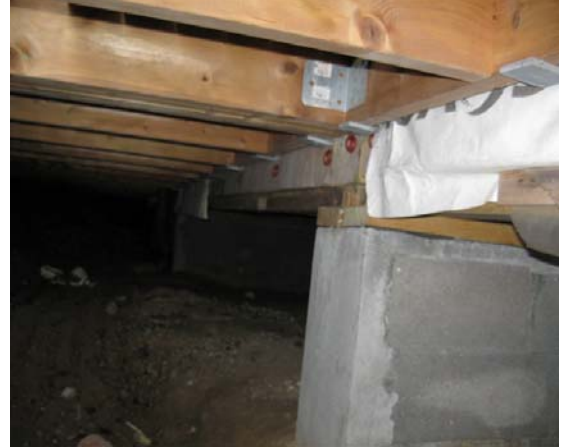
Figur 90 Der er ikke lagt membran på jorden
