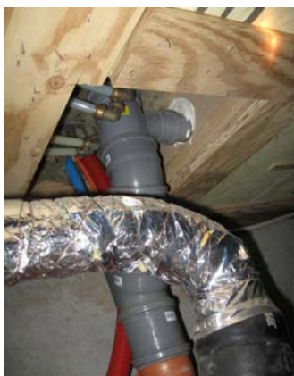
Figur 82 Eksp. rør mgl. Vindsp.
