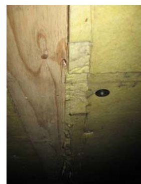
Figur 87 Fastholdt pladeisolering under vådrum
