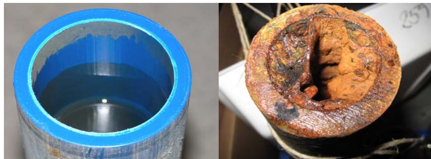
Figur 39: Illustration af indersiden i ét af PE-rørene (t.v.) og ét af støbejernsrørene (t.h.) udtaget fra ledningsnettet i Nordvand A/S.
