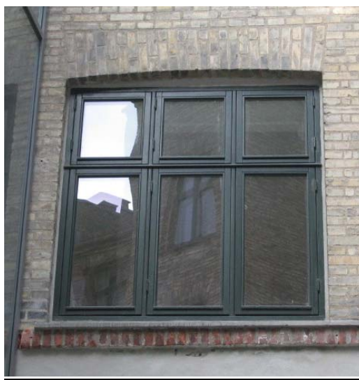
Figur 14. Vindue 3 set udefra
