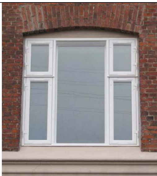
Figur 7. Vindue 2 set udefra.
