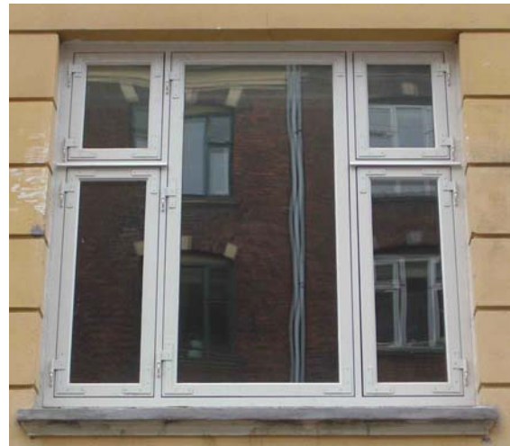
Figur 4. Vindue 1 set udefra
