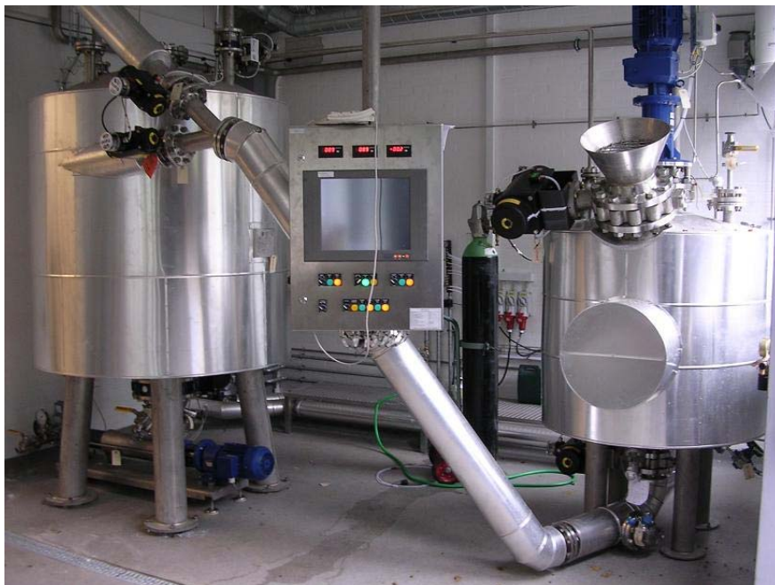
Figur 2.2. Vådoxidationsanlæg i pilot skala på BioCentrum-DTU (reaktor til højre, flash tank til venstre)
