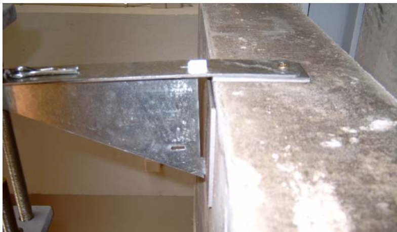
Figur 3. Konsolbeslag med udvendigt mellemlæg og mellemlæg i falsen anbragt glat med vægdersiden (oversiden)
