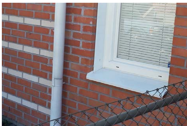
Figur 16. Billede af løsning i stil med den der er skitseret i figur 15. Såløbets endebunde støder blot op mod murværket, men burde bør være ført ind i murværket for at hindre vand i at trænge ind i isoleringen.
