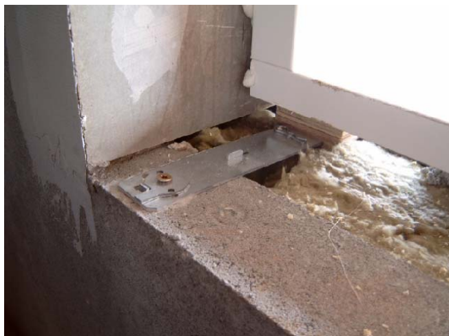
Figur 9. Monteret konsolbeslag med vindue. Spændpladen står i sin laveste position. Havde den været brugt kunne opklodsningen have været reduceret. Det ses at der let opstår isoleringsfejl omkring konsollen.
