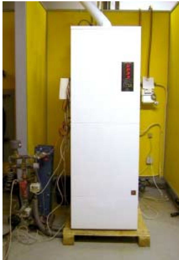
Figur 2-3: Solvarmeanlæggets varmelager. Til venstre for varmelageret ses den fiktive radiatorkreds, der anvendes ved simulering af rumvarmeforbrug.
