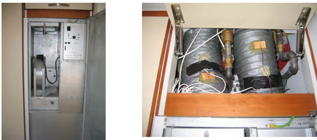
Figur 2. Til venstre ses aggregatet med åben skabslåge (midt i billedet ses friskluft-ventilatoren). Til højre er vist den øverste del af aggregatet, hvor kanalsystemet er tilsluttet.
