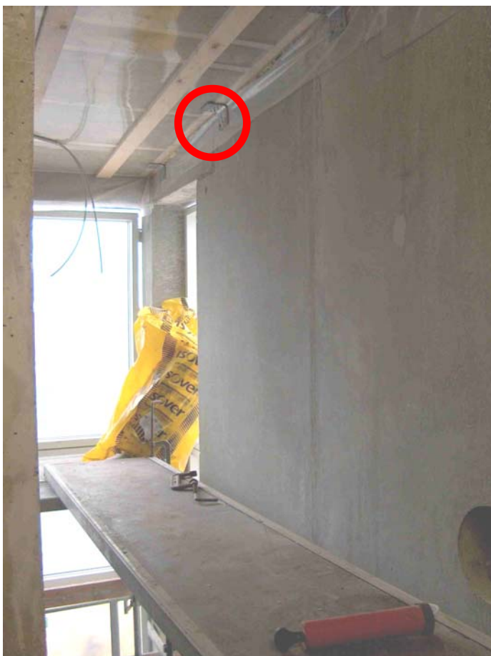
Billede 1 – Beslag i trappeopgang på tagekassette placeret forkert.
