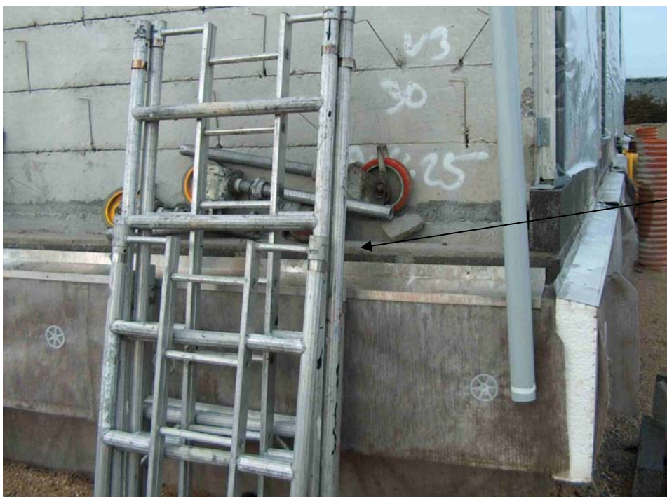
Billede 1 – Frostsprængt sokkel.
