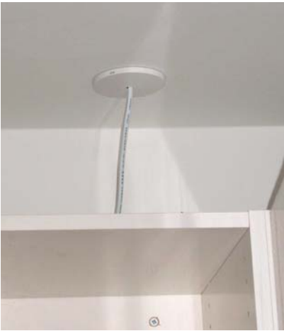
Billede 4 – Ledningen stammer fra det nedhængte loft.
