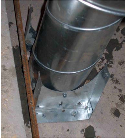
Billede 3 – Utraditionel fiksering af ventilationsrør via bæring.
