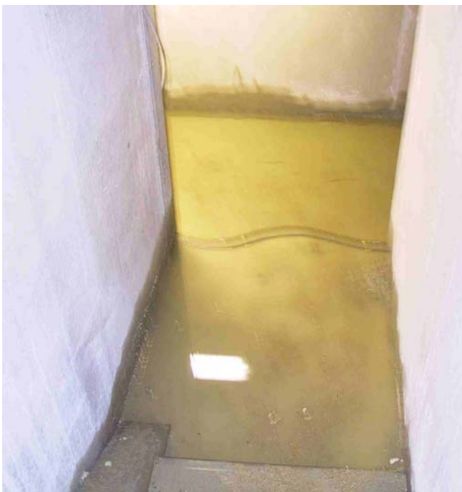
Billede 1 – Vand i kælder.
