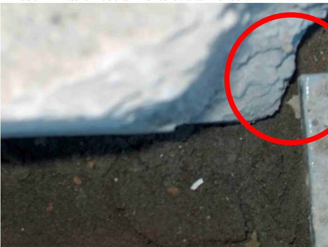
Billede 3 – Der er hakket af kantstøbningen for at få plads til altankonsollen.
