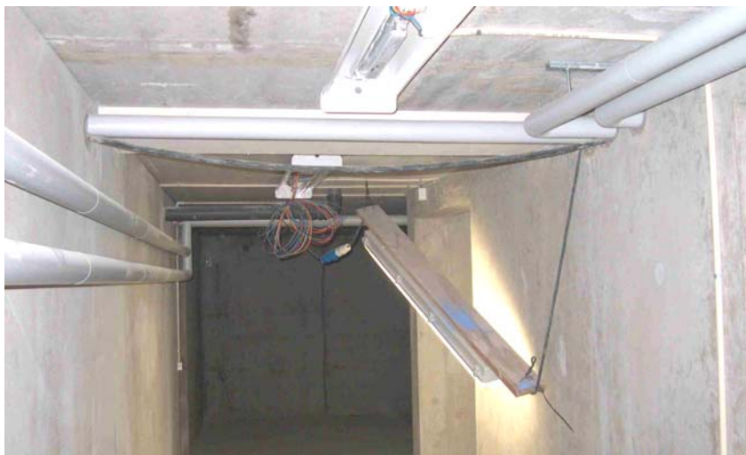
Billede 2 – Indstøbt el-ledning til føring af byggestrøm.
