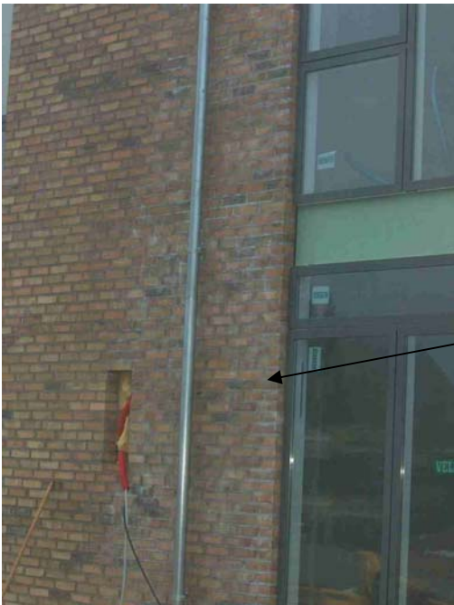
Billede 1 – Udtræk på murværk.
