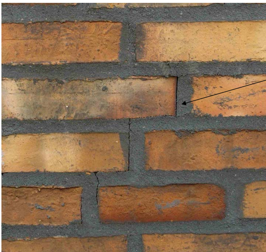
Billede 2 – Nærbillede af revne i murværk.
