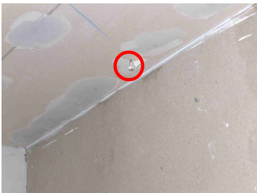
Billede 1 – Skrue i gipsloft.
