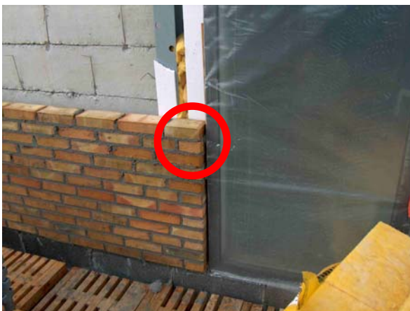
Billede 3 – Opmuret murværk ved altansøjle
