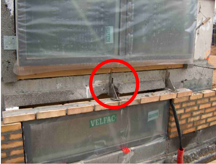
Billede 2 – Overlægger ved kældervindue.
