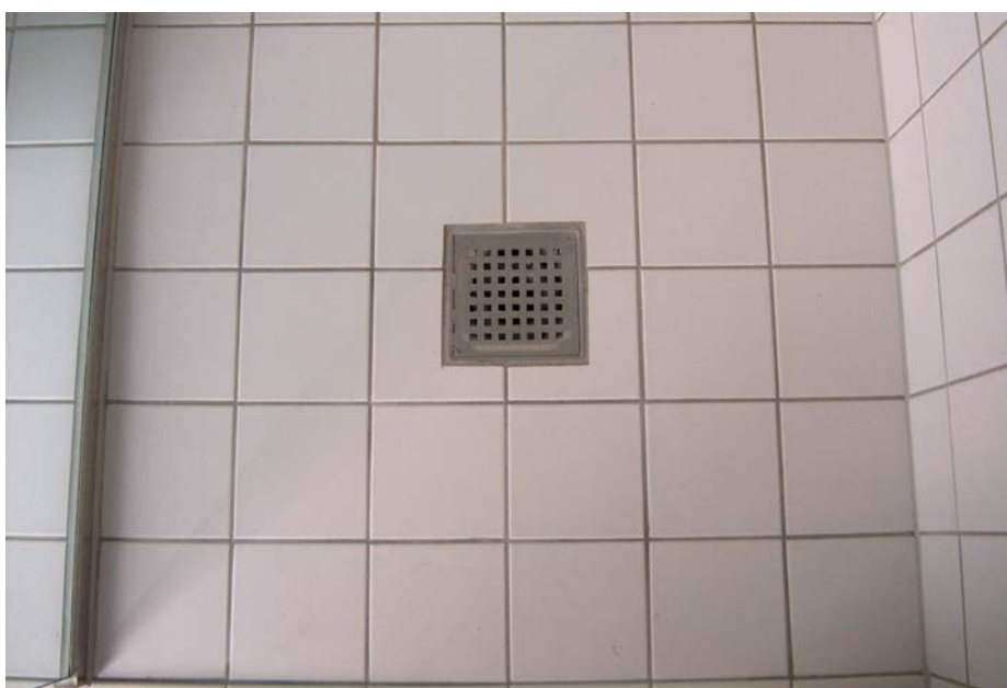
Billede 1 – Ikke centreret afløb i flise
