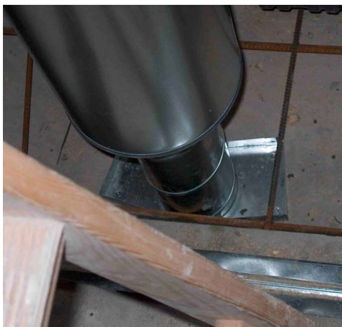
Billede 2 – Bæring monteret omkring ventilationsrør.
