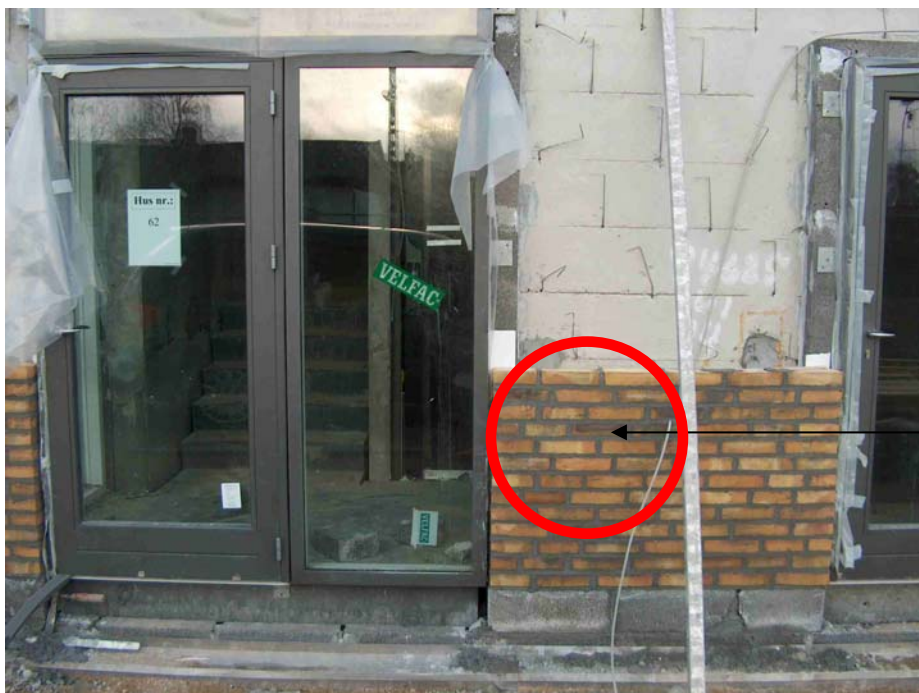
Billede 1 – Revne i murværk.
