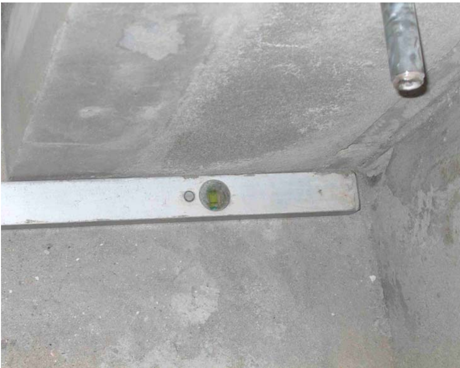
Billede 1 – Ujævn væg ved regulator til gulvvarme.
