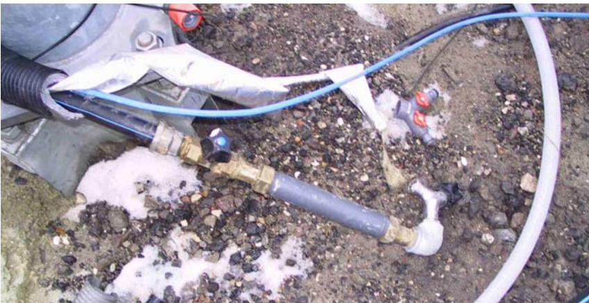
Billede 3 - Vand etableret på ikke lovlig vis.
