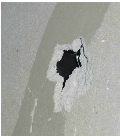
Billede 2 – Hul i element close-up. Hullet har en størrelse på 8 cm på det bredeste sted, og 8 cm højde på det højeste sted.
