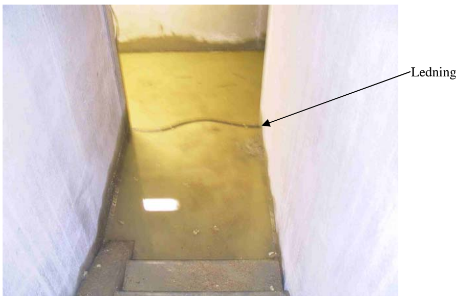
Billede 1 – Vand i kælder på punkthus.
