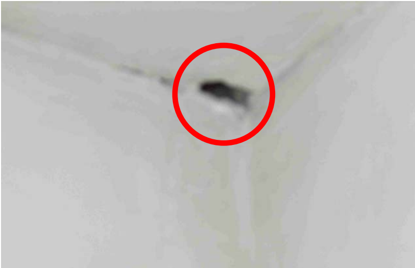
Billede 1 – Viser hullet i hjørnet i gipsloftet.
