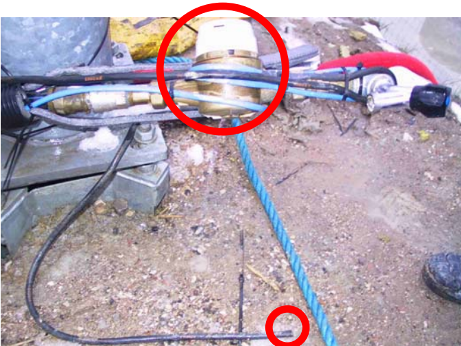
Billede 2 - El-tracing er ikke tilsluttet, den sorte ledning i bunden af billedet stammer fra el-tracing. Resultatet er en sprængt vandmåler.
