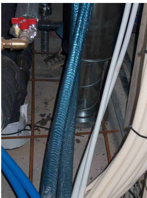
Billede 1 – Jern i skakt omkring ventilationsrør.
