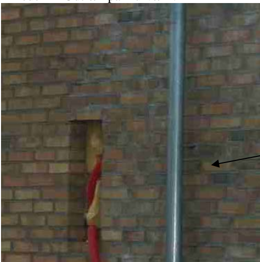
Billede 2 – Udtræk på murværk.
