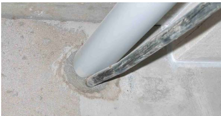
Billede 1 – Indstøbt el-ledning til føring af byggestrøm.
