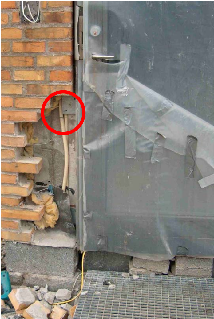
Billede 1 – Defekt ledning til dørtelefon.
