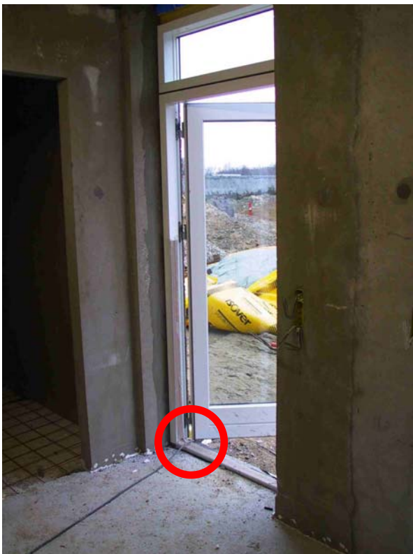
Billede 1 - Ledningsføring gennem dør.
