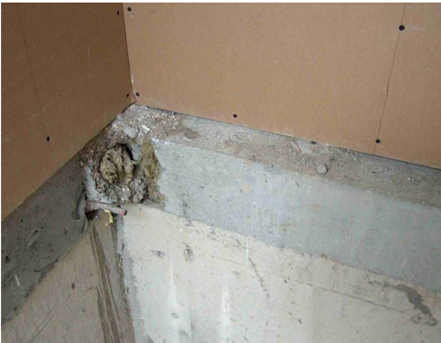
Billede 2 – Nærbillede af samling ved affaldsskakt, hvor forskydningen mellem beton- og gipsvæg på 10 cm ses.
