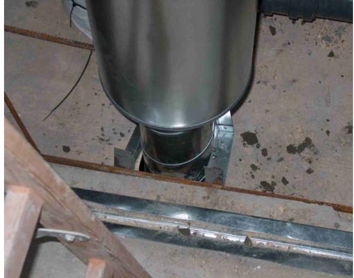
Billede 4 – Utraditionel fiksering af ventilationsrør via bæring.
