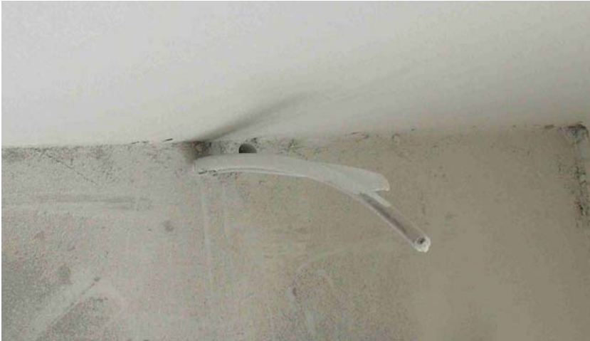
Billede 1 – Ledninger er trukket for langt fra væg.
