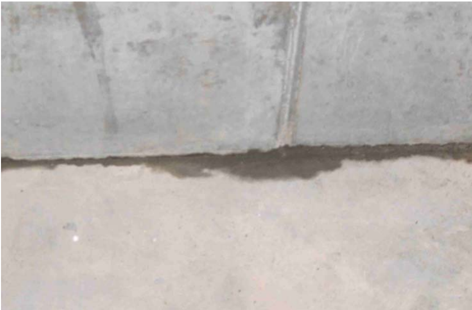
Billede 1 – Billedet viser vandindtrængning mellem kældergulv og -væg.
