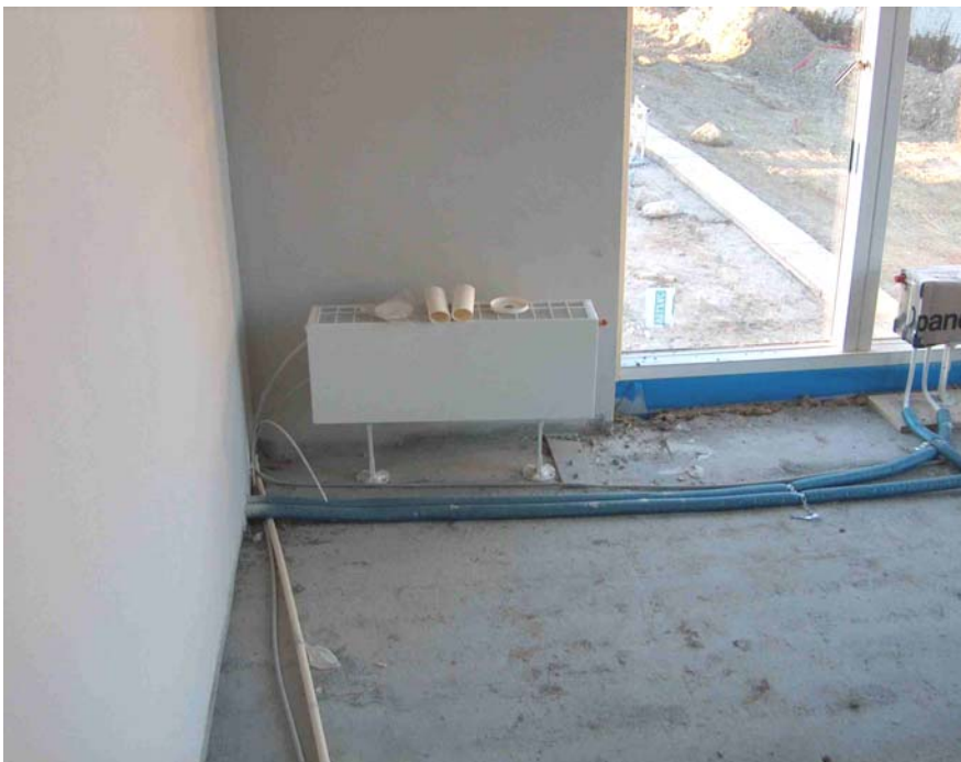
Billede 1 – Ekstra ikke-tilsluttet radiator.
