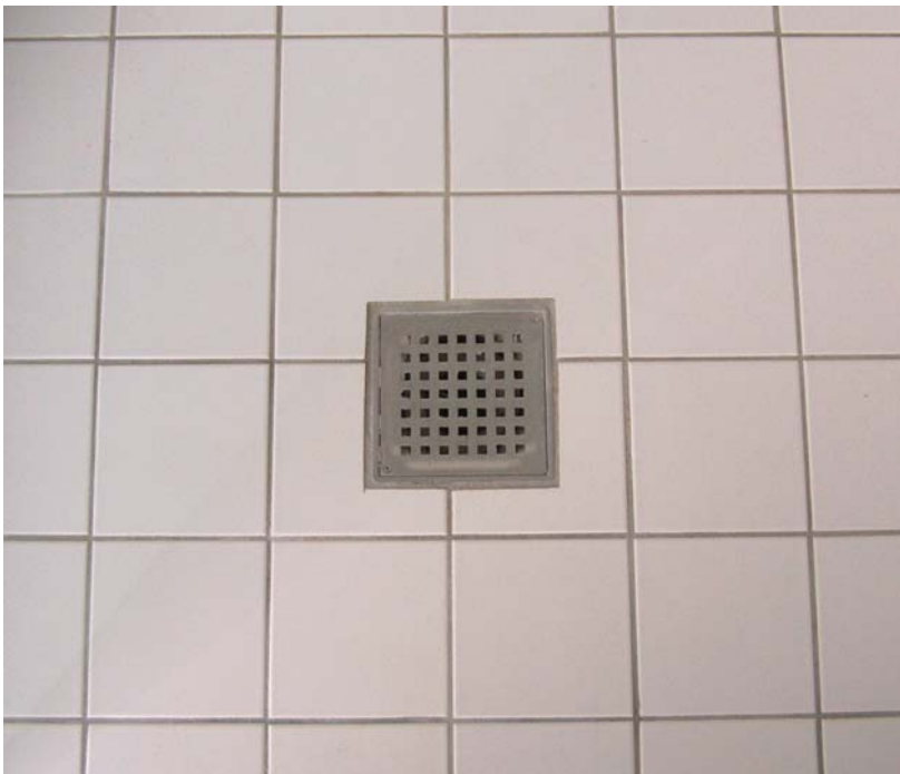
Billede 2 – Afløb i bruseniche set ovenfra.
