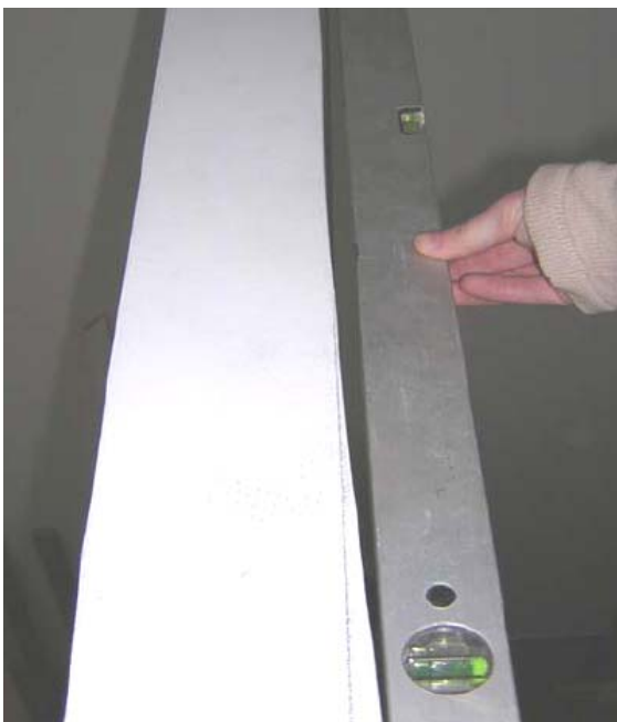
Billede 2 – Skævt element ved trappeskakt.
