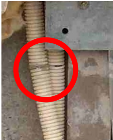
Billede 2 – Defekt ledning til porttelefon.
