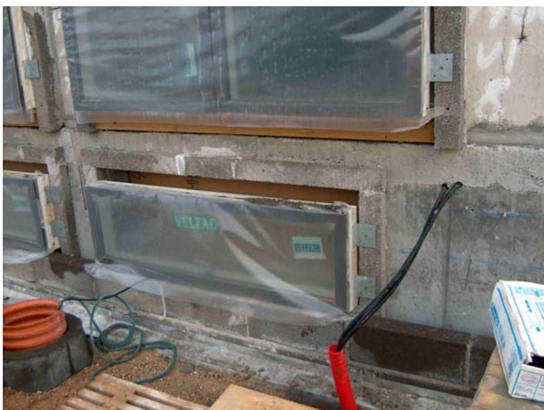
Billede 1 – Byggestrøm trukket gennem boret hul i konstruktionen.
