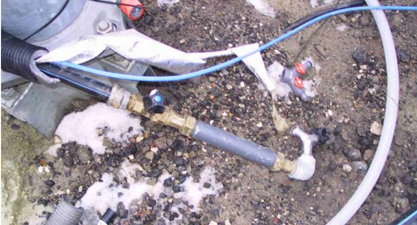
Billede 1 - Vand etableret på ikke lovlig vis, vandmåler er nu afmonteret og et mellemstykke påsat i stedet, der er dog stadig ikke udført den lovpligtige vinterforanstaltning i form af el-tracing.
