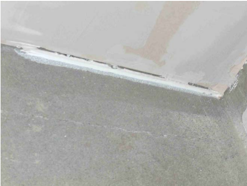
Billede 1 – Fuge sluppet ved gipsloftet.
