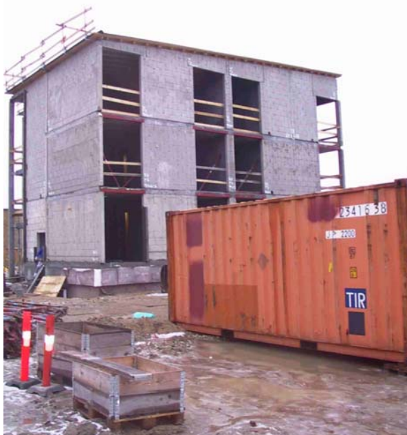
Billede 1 – Manglende overdækning.
