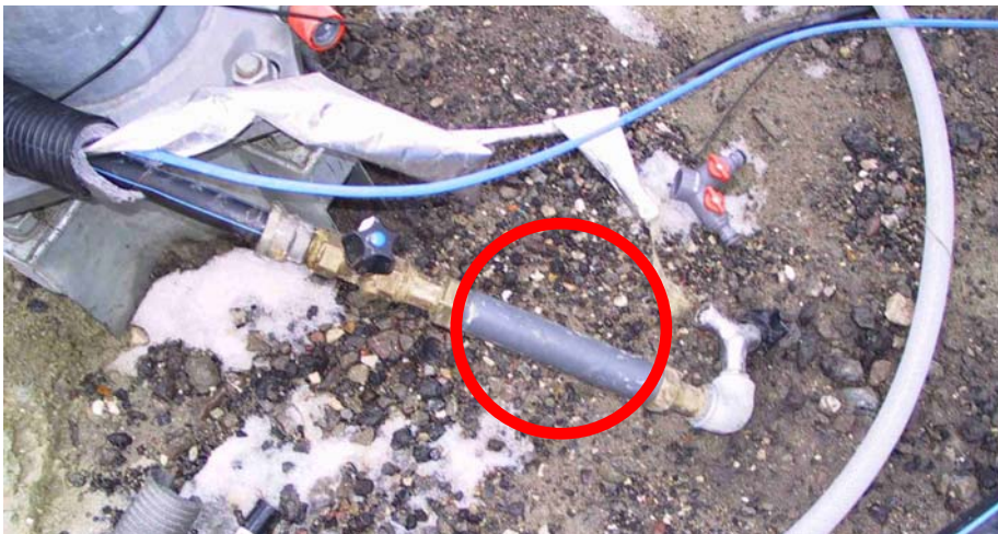
Billede 1 - Vand etableret på ikke lovlig vis, vandmåler udskiftet med mellemstykke, men stadig uden el-tracing.
