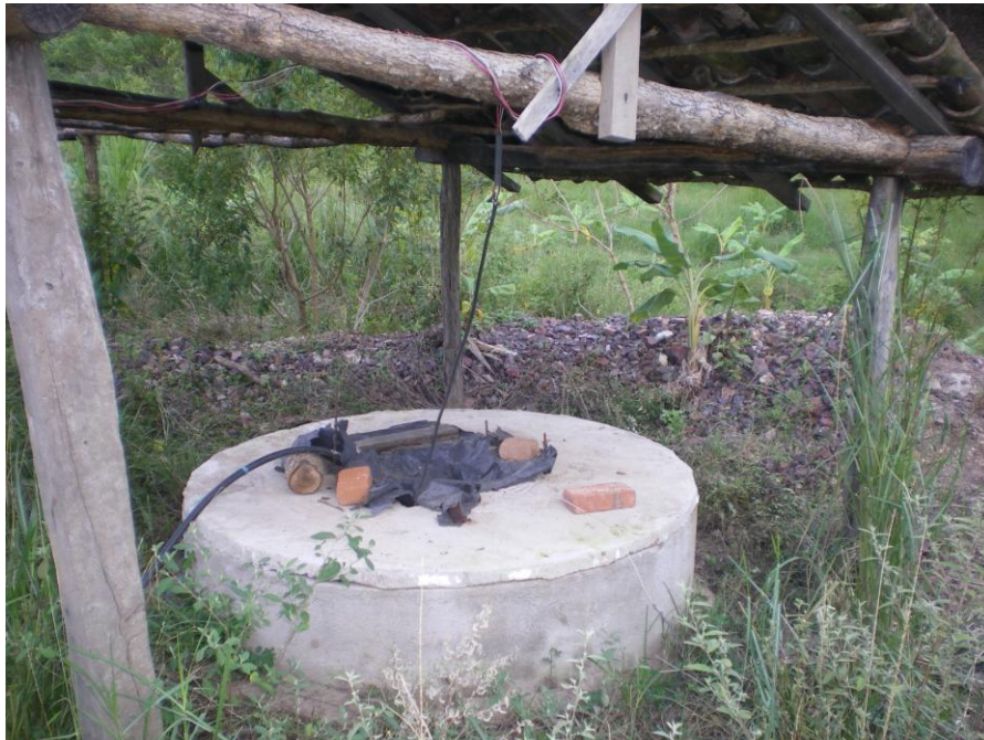
Figura 36: Miniacueducto por bombeo eléctrico
