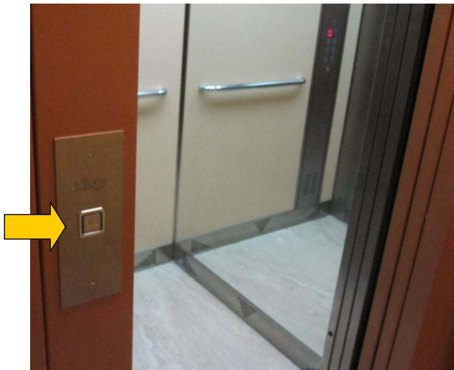
Fig. 4. Botonera exterior en un ascensor de domicilio particular
