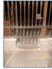
4. Estrechamiento de 80cm en el acceso al coro.
