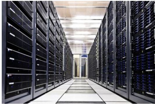
Figura 1.2: Sala de servidors al CERN
