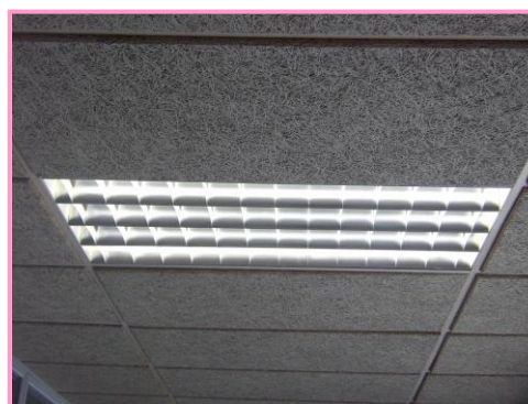
Figura. 9.1: Luminària de 4 fluorescents situada a la sala general d'oficines. Font: elaboració pròpia.
