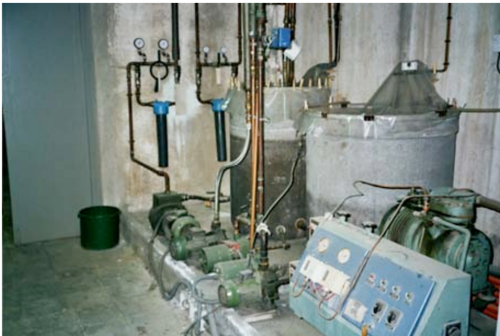
Figura 49: Sala de serveis del laboratori de RX, situada al soterrani de l'edifici de l'Escola d'Enginyers (fotografia de l'autor).
