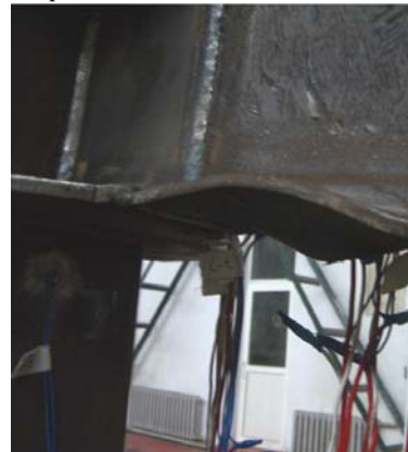
(d) Buckling of beam in joint B
