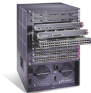
Figura 2.4.1: switch modular Cisco Catalyst 6509, com l'utilitzat al PIC
