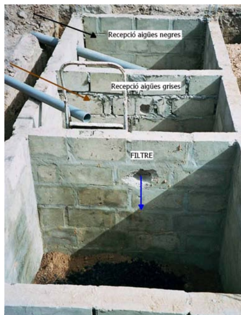
Figura 24: Compartiments de recepció de les aigües negres i grises i compartiment d'evacuació (filtre). Font: Bafalay (2004)
