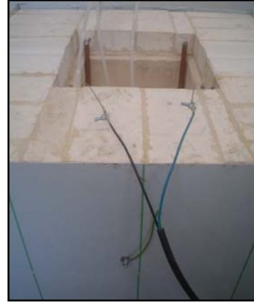
Figura 32. Toma de tierra
