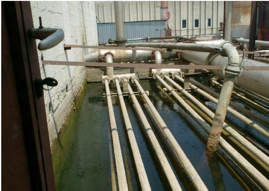
Εικόνα 2.4: Τμήμα εκχύλισης ψύξη – συμπύκνωση εξανίου (ΕΛΚΕ Α.Ε. Greece 2010)
