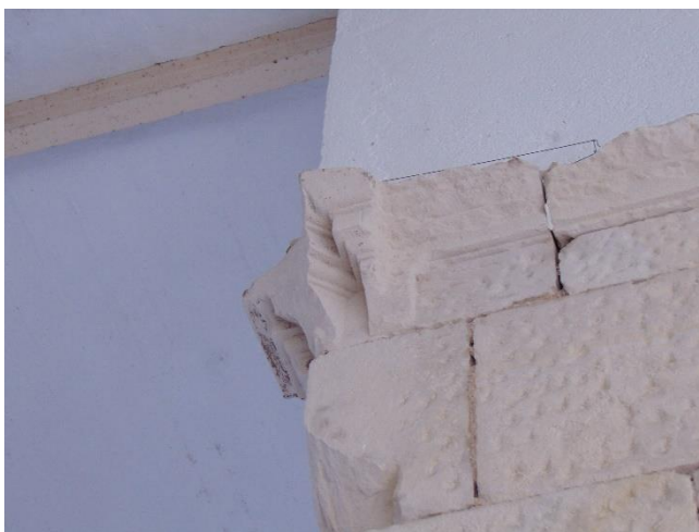
Figura 7 - Mísula parcialmente destruída
