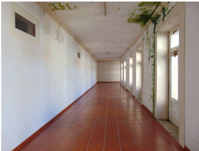
Figura 16 - Corredor do 2º piso do claustro visivelmente degradado
