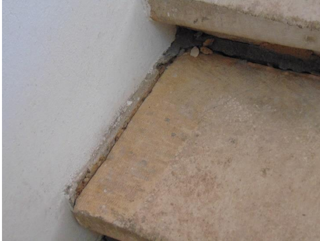
Figura 14 - Pormenor da escada de acesso ao 2º piso do claustro, visivelmente danificada
