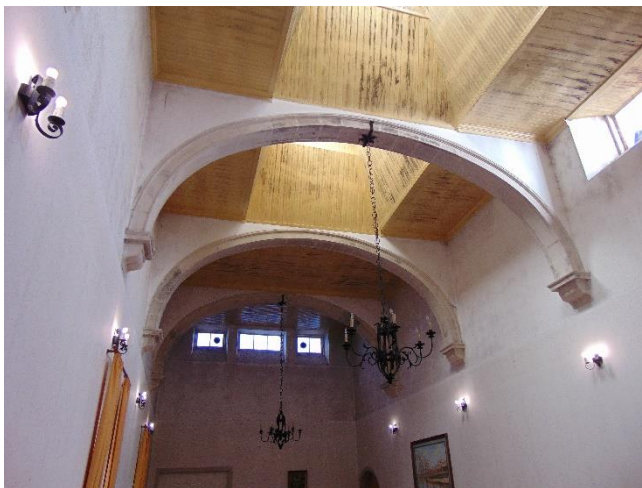
Figura 10 - Tecto do refeitório
