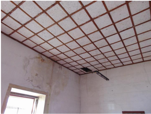
Figura 23 - Outro tecto em madeira no 3º piso, visivelmente degradado
