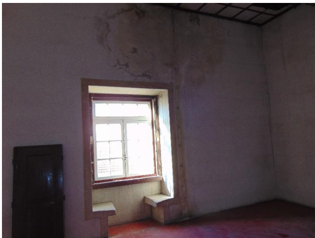
Figura 25 - Estado de degradação de uma secção no 3º piso
