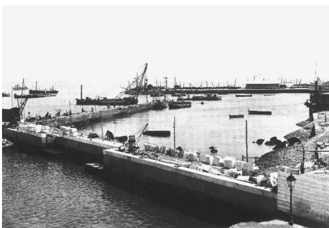
Obras del primer tramo en construcción del muelle Reina Victoria en el Puerto de Cádiz en 1908. Autoridad Portuaria de Bahía de Cádiz.
