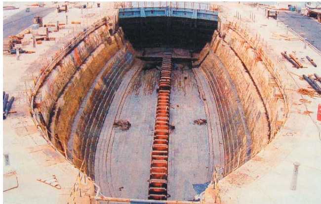
Dique de San Antonio en La Carraca, construido por D. Tomás Muñoz, Empresa Nacional Bazán, S.A.
