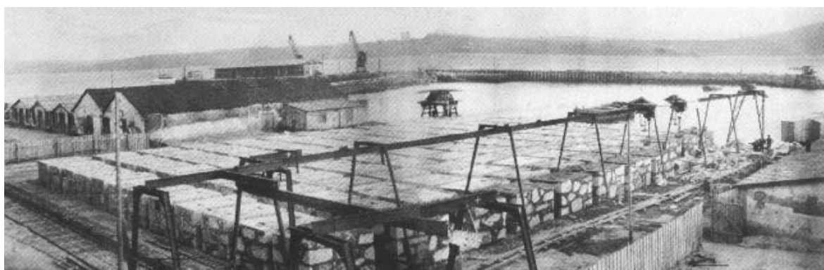
Vista general del inicio de la construcción del muelle de Ribera hacia 1937 en el Puerto de Ferrol. C. Arenal y Fernández Ladreda.
