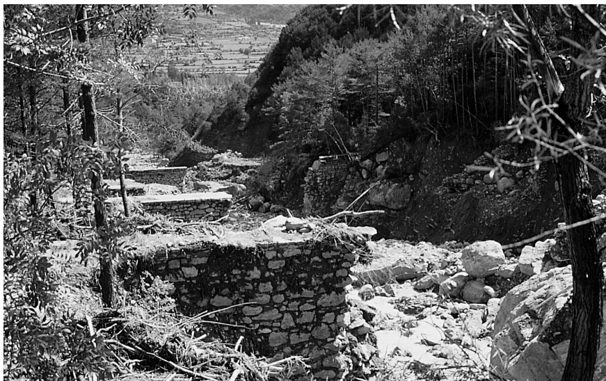
Foto 1. Imatge dels dics de contenció del barranc d'Arás a Biescas trencats per la torrençada del 7 d'agost de 1996. J. M. Vilaplana.
