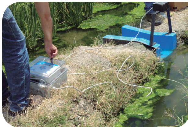
Figura 38. Instalación de un sensor de ultrasonido y datalogger .
