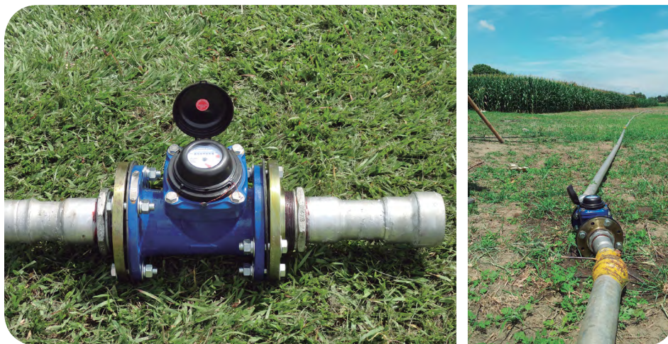
Figura 32. Medidor de caudal en un sistema de riego por aspersión.
