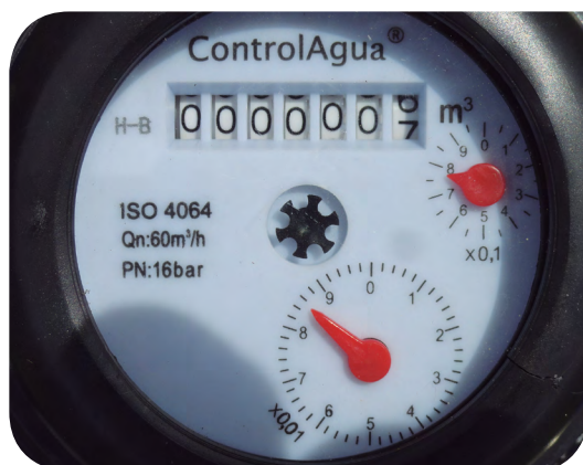
Figura 33. Lectura en un medidor de caudal.
